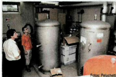
Neue Boiler für die zentrale Warmwasserversorgung.
